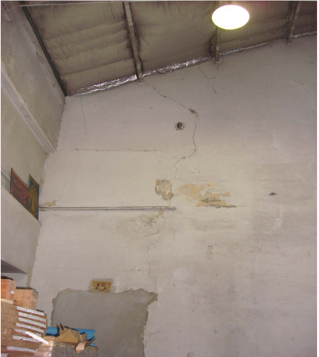
Foto Nro. 3 – En la presente vista se pueden ver en este lugar de la imprenta una pared que muestra en su estructura una rajadura desde el techo hasta el piso, en el medio de la misma, rastros de humedad y más arriba una boca de electricidad sin tapa y con los cables de electricidad expuestos y encintados.
